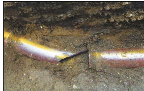
【陶製の取付管の破損】
