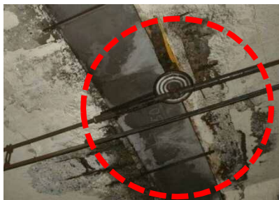
【コンクリ片はく落状況】
