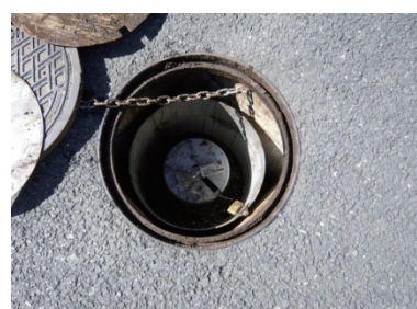
写真－６ 貫井南町
