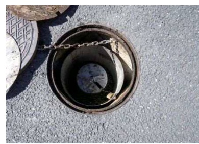
写真-6 貫井南町
