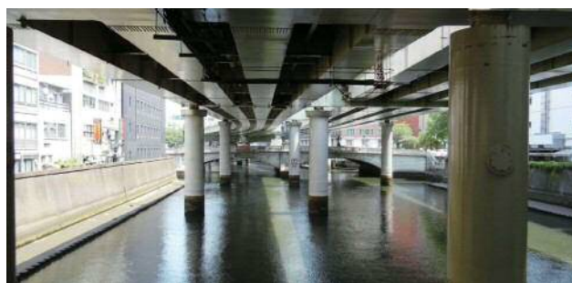
図-6 日本橋上空と日本橋川を縦断占用する首都高の桁下空間と橋脚（筆者撮影）
