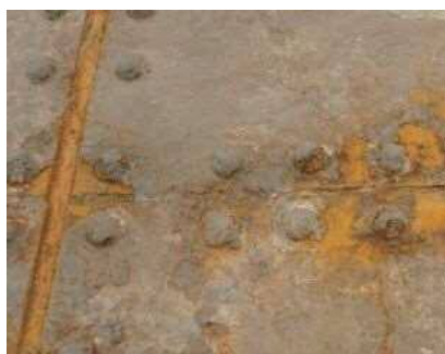
写真-10 蔵前橋 BP 上面リベット腐食状態
