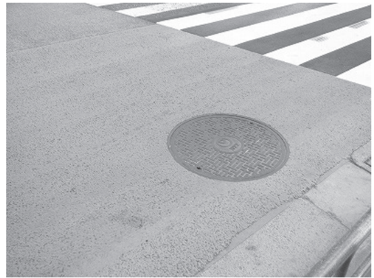
写真-7の3 汚れ（凹部の土砂）
