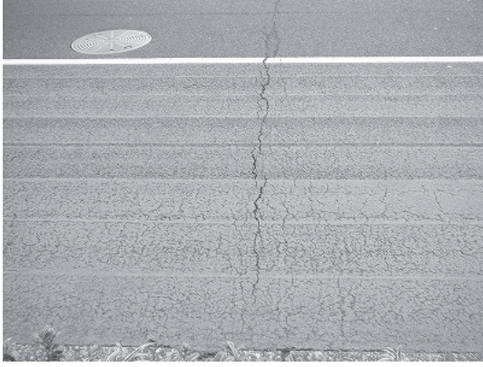
写真-5の1 クラック
