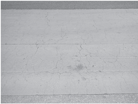
写真-5の2 クラック
