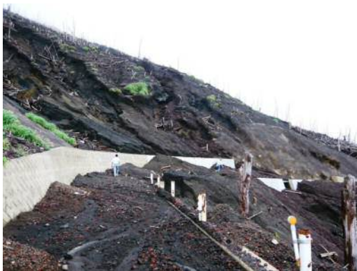
写真-1 林道雄山環状線の再被災状況
