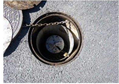
写真- 6 b 貫井南町(通路)観測井
