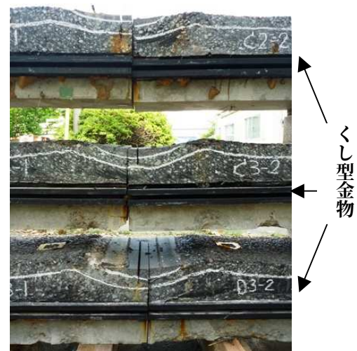
写真-4 遊間部側の切断面
