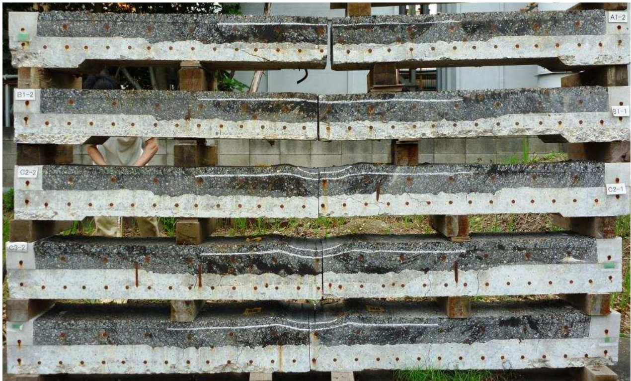
写真-3 床版主鉄筋方向切断面のひび割れ
