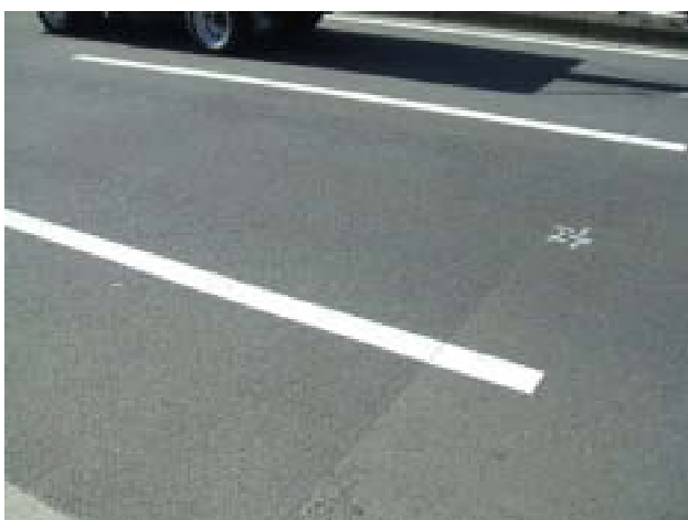
写真-3 面荒れ（レベル低：一骨材の飛散が全体に広がっている段階）
