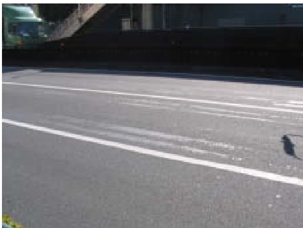
写真-2 アスファルト分等の付着（アスファルト分等が舗装表面に付着している状態）
