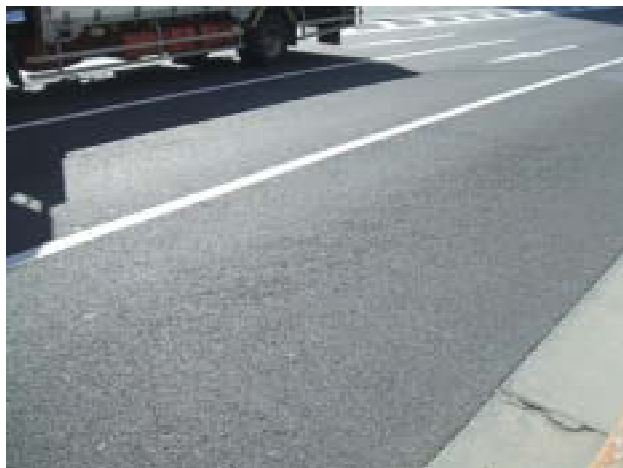
写真-4 面荒れ（レベル中：一骨材の飛散箇所(レベル低)に加え、複数の飛散箇所が広がってきている段階）
