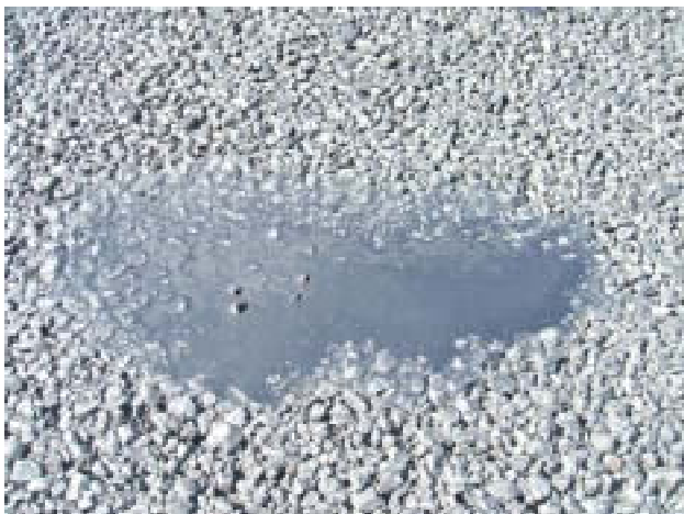
写真-1 アスファルト分過多状態（アスファルト分が部分的に多くなり、混合物が不安定な状態。油が原因であることが多い）
