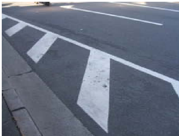
写真-5 面荒れ（レベル高：複数の飛散箇所が全体に広がっている段階、ポットホール的一步手前）
