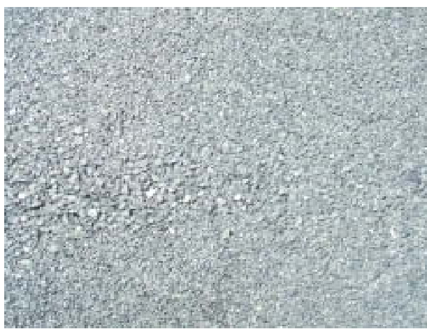
写真-6 6号碎石の露出状況
