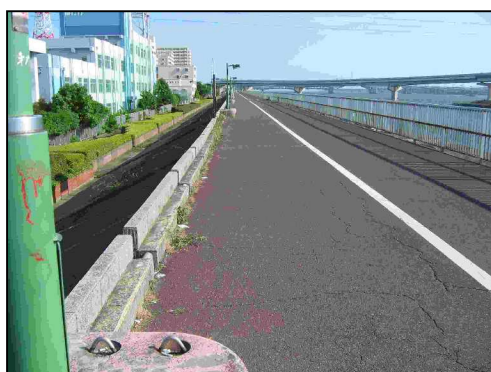
写真－1 中川左岸堤の現状
