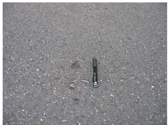
写真 - 2 A・B 工区のピンホール(進行はなかった)
