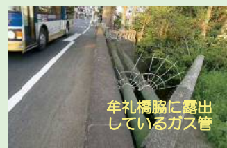
写真 牟礼橋 牟礼橋脇に露出しているガス管
