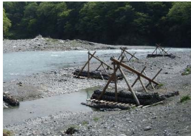
多摩川・柚木町地先 聖牛が設置されている
