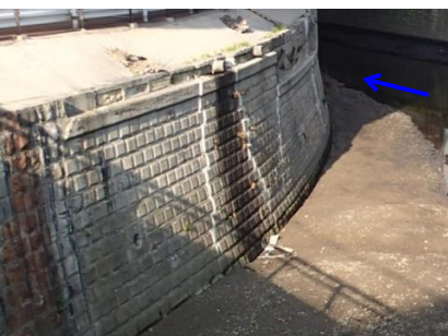
護岸の老朽化 (古川)
