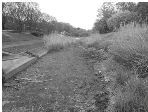
渇切れした野川（第2調節池下流・平成21年度）
