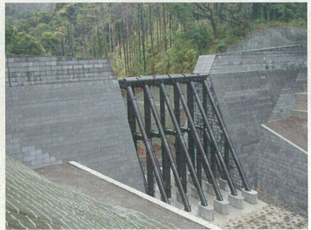
釜の尻沢(高さ 14.5m 長さ 61.9m) コンクリートダム(平成 17 年度完成)
