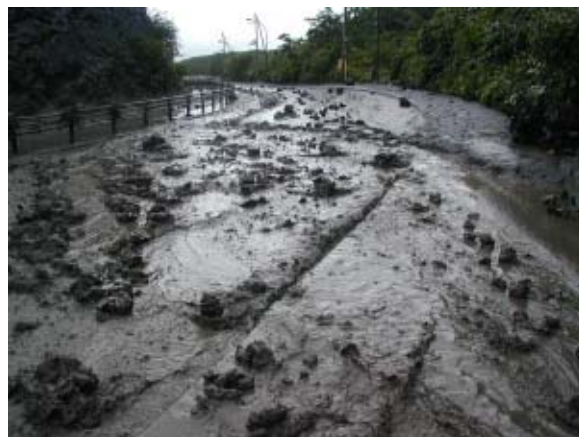
泥流による都道の被害(三七沢)
