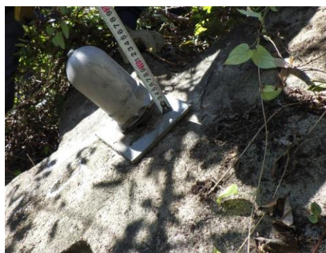
ロックボルト工の頭部の破損
