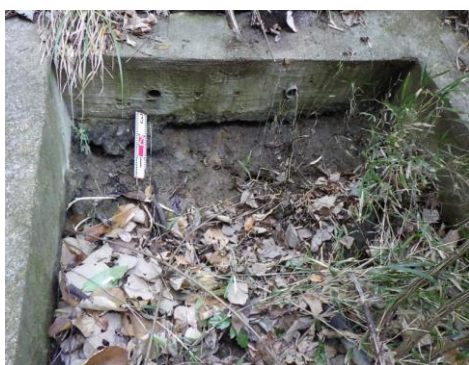
法枠内の土砂流出
