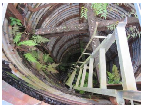
集水井工の劣化
