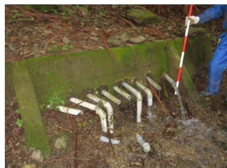
横ボーリング工の破損
