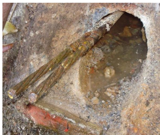
アンカーの腐食
