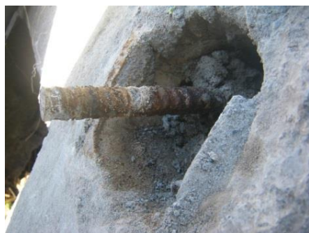
ロックボルトの腐食
