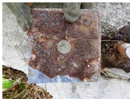
支圧板の腐食
