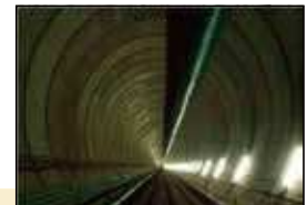
白子川地下調節池 (既設)
